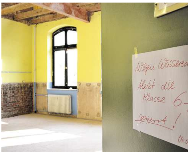
Wasserschaden im Campe-Gymnasium.
